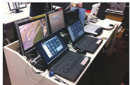
常時稼働の防災用監視設備
