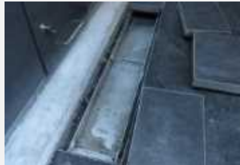
ケーブルピット-2
