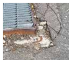
①雨水桝のふたの破損
